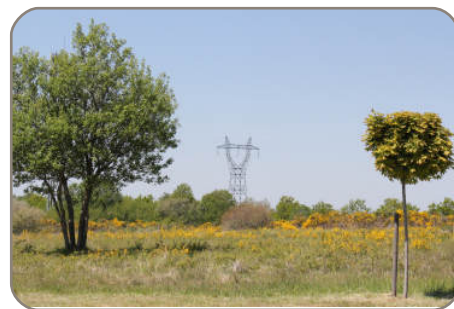
Ligne électrique sur le site
